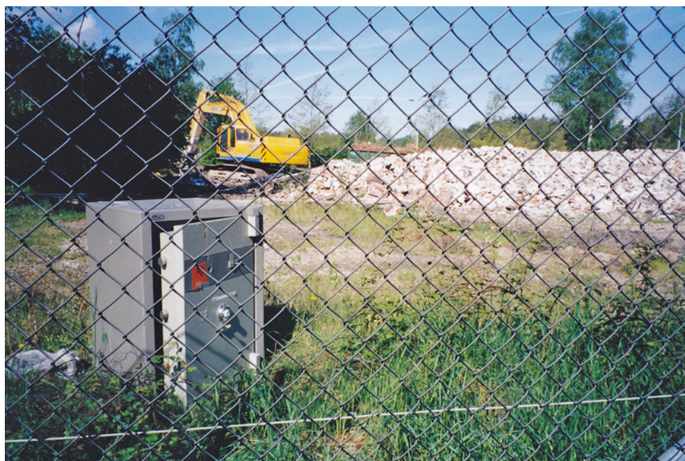
Kluis uit het bureelgebouw dat in gruis op de achtergrond te zien is.
